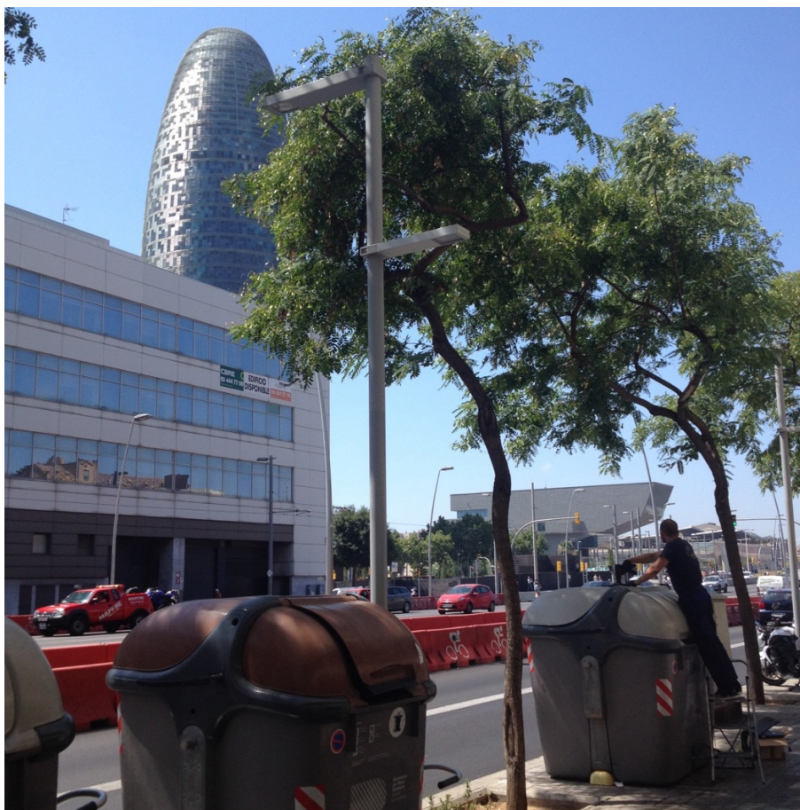
Figura 2. Instalación de sensores volumétricos en la ciudad de Barcelona.
