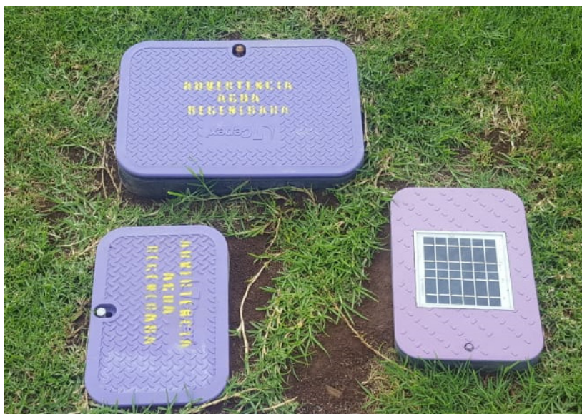
Figura 3. Ejemplo de la instalación del hardware Smart dentro de la arqueta con panel solar (esquina inferior derecha).
